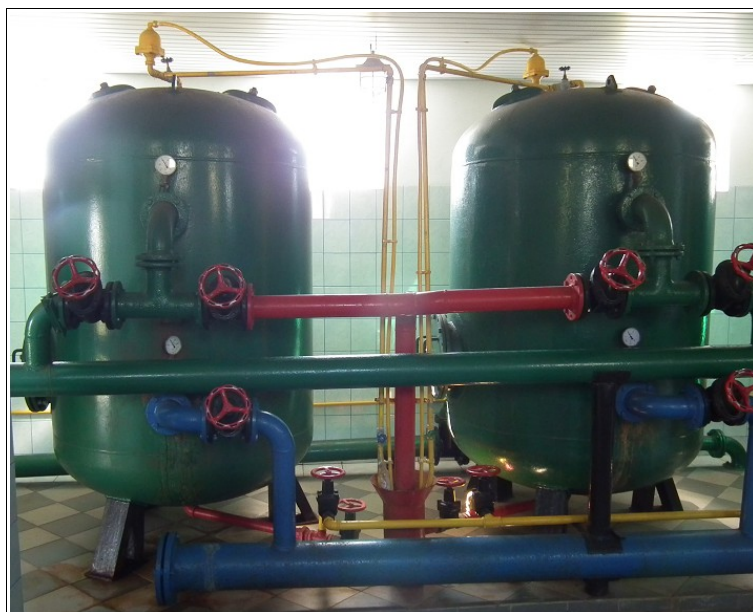
Zdjęcie 4. Filtry ciśnieniowe
